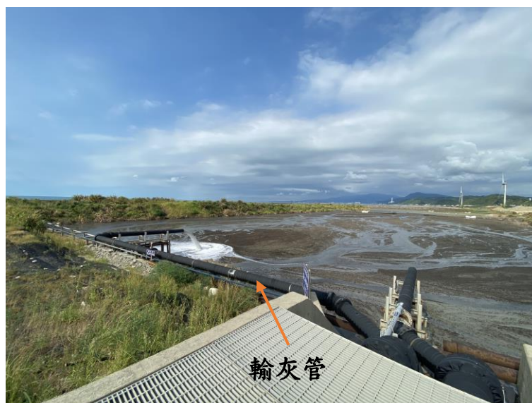
圖 3-1 林口電廠排灰情形(台電內部資料)
