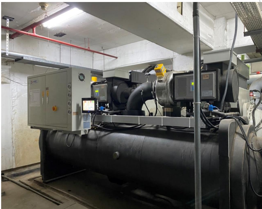
汰換後磁浮機組
