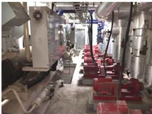
體育館空調機房
