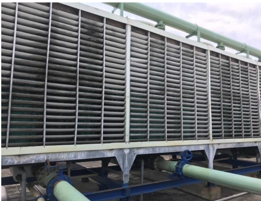
既設1600RT水塔
