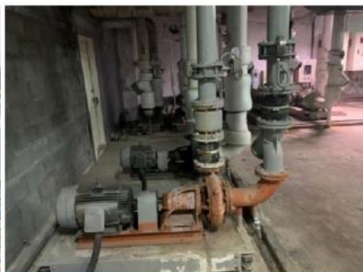
水泵動力設備
