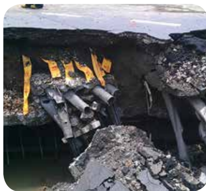
地下管路及電纜受損嚴重
