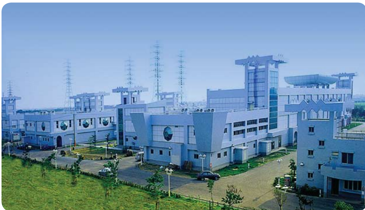
南科超高壓變電所
